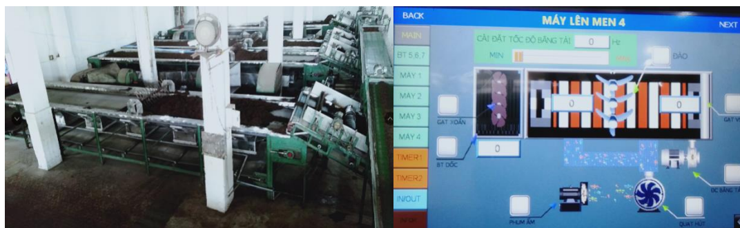
Hình 11. Một vài hình ảnh hệ thống hoàn thiện
