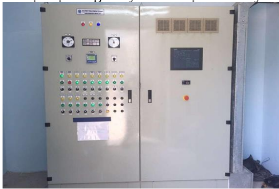
Hình 2. Tủ điện hệ thống xử lý nước
