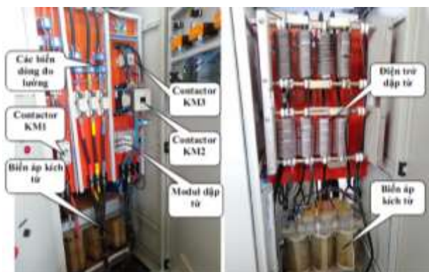
Hình 9. Tủ biến áp kích từ và điện trở dập từ
